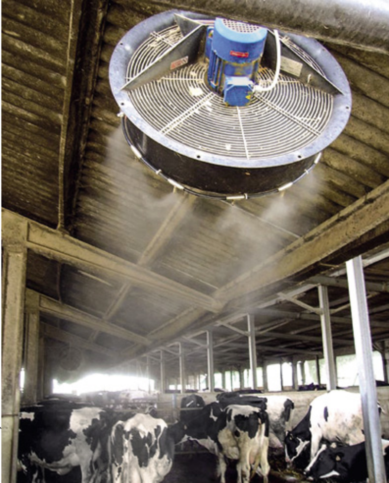
Dank des feinen Wassernebels lässt sich die Lufttemperatur im gesamten Stall um bis zu 8°Celsius absenken.
